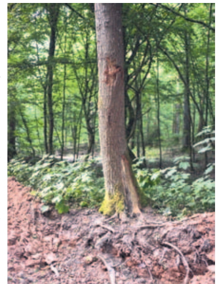
Dieser Baum sollte erhalten bleiben. Doch Bauarbeiter verletzten massiv die Rinde und rissen die Wurzeln ab, er wird nicht überleben. Ebenso wie etliche andere Gehölze am Wegesrand.
