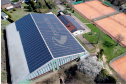
945 Module, 1600m 2 Belegung, Erzeugung von ca. 246.000 kWh Strom im Jahr
